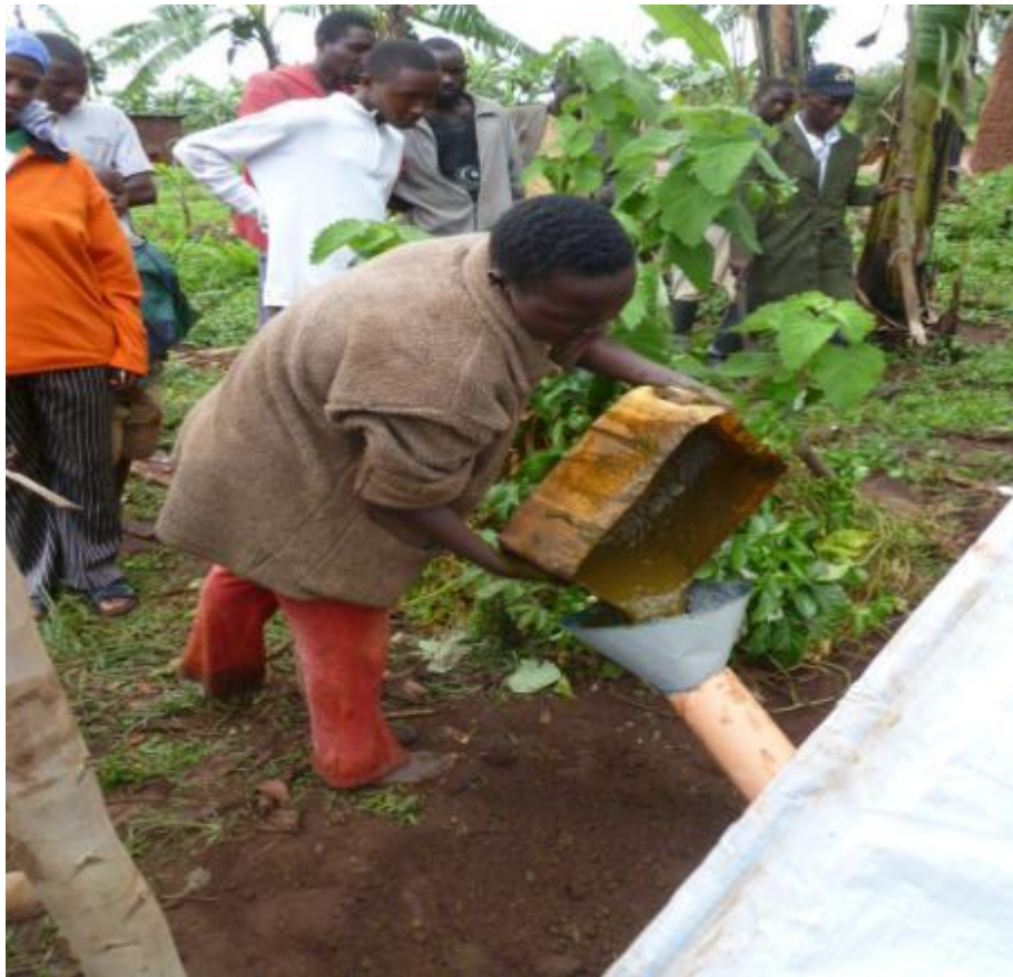
Système Flexi Biogas avec ballon de stockage du gaz excédentaire
