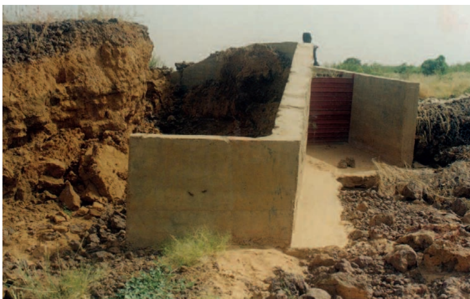
Photo 10: Destruction du remblai après l'apparition d'un renard au niveau du contact entre le bajoyer et le remblai (barrage d'Oued Abary, Brakna).
