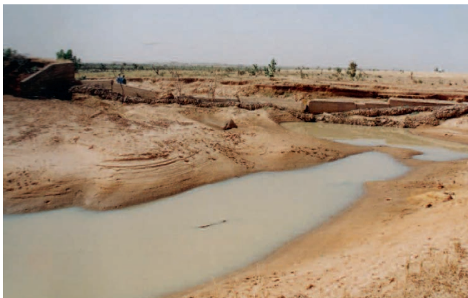
Photo 7: Destruction d'un évacuateur de crues placé en position latérale par suite d'un phénomène d'érosion régressive (barrage de Bambéra, Hodh El Gharbi).
