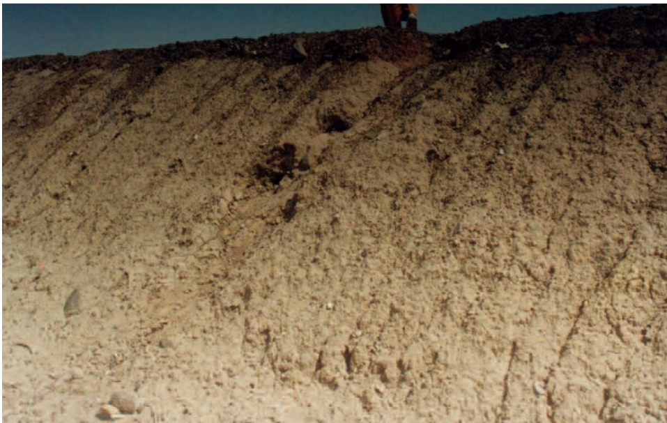
Photo 6: Talus aval non protégé du barrage d'Amdar-Atar (Adrar). De profondes griffures d'érosion sont apparues et la pente du talus s'en trouve déjà modifiée par endroit, ce qui compromet la stabilité de l'ensemble de l'ouvrage.
