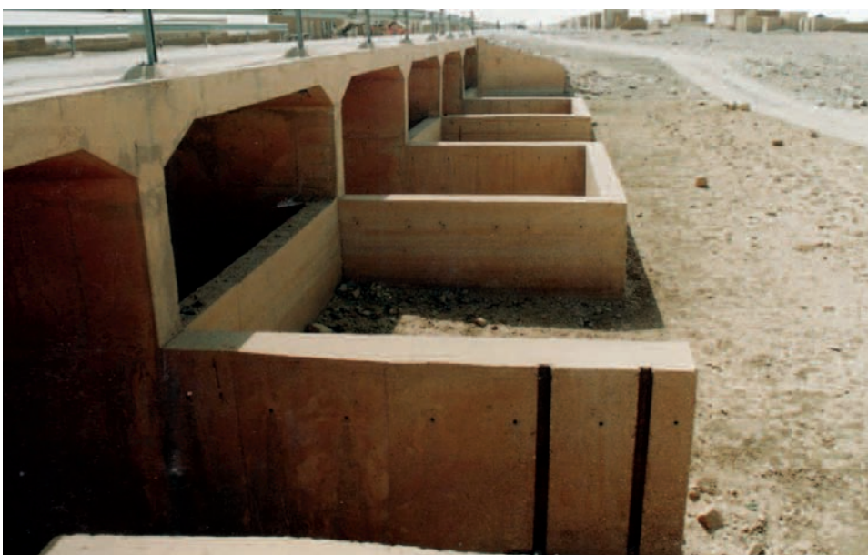
Photo 11: Déversoir en créneaux sur le barrage routier d'Achram (Tagant). Il inclut également une vidange par passe batardée (ouverte, au premier plan). N.B.: cet exemple présente toutefois un défaut majeur car aucun bassin de dissipation n'a été réalisé à l'aval de la structure déversante, qui risque donc de subir des affouillements.
