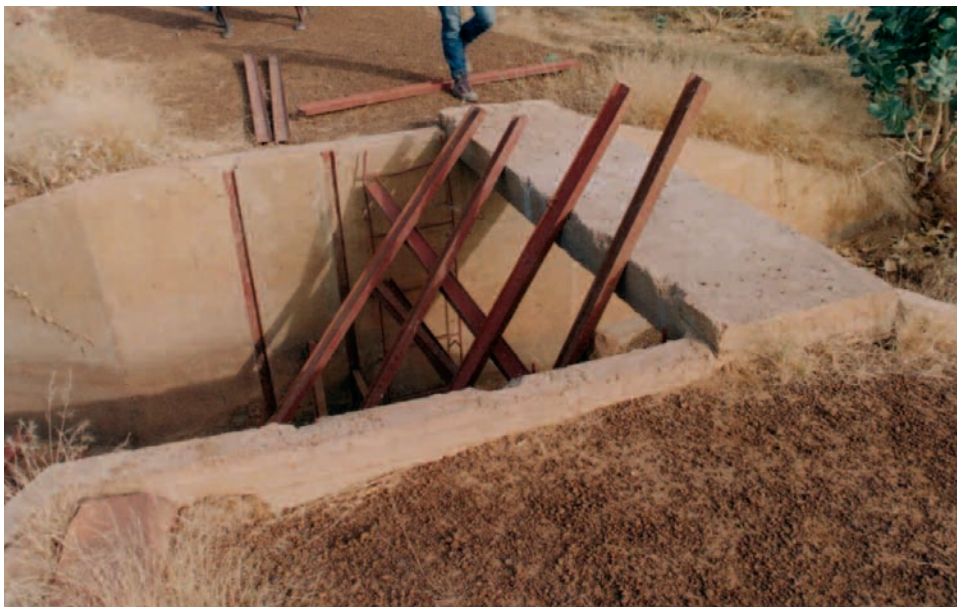
Photo 15: Ouvrage de vidange "classique" en béton. Barrage de Boukhleikhil (Hodh el Gharbi).
