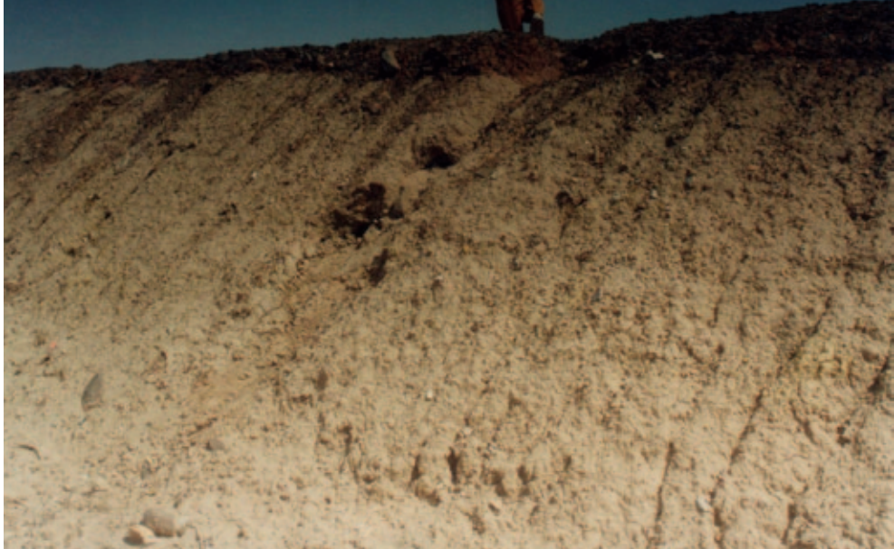
الصورة 6: الجانب الأسفل غير المحمي بسد أمدير أطار (أدرار). لقد ظهرت خدوش عميقة بسبب التآكل ما أدى إلى تغيرات في بعض المناطق لانحدار الجانب الأسفل للسد، وهو ما يهدد استقرار المنشأة بأكملها.
