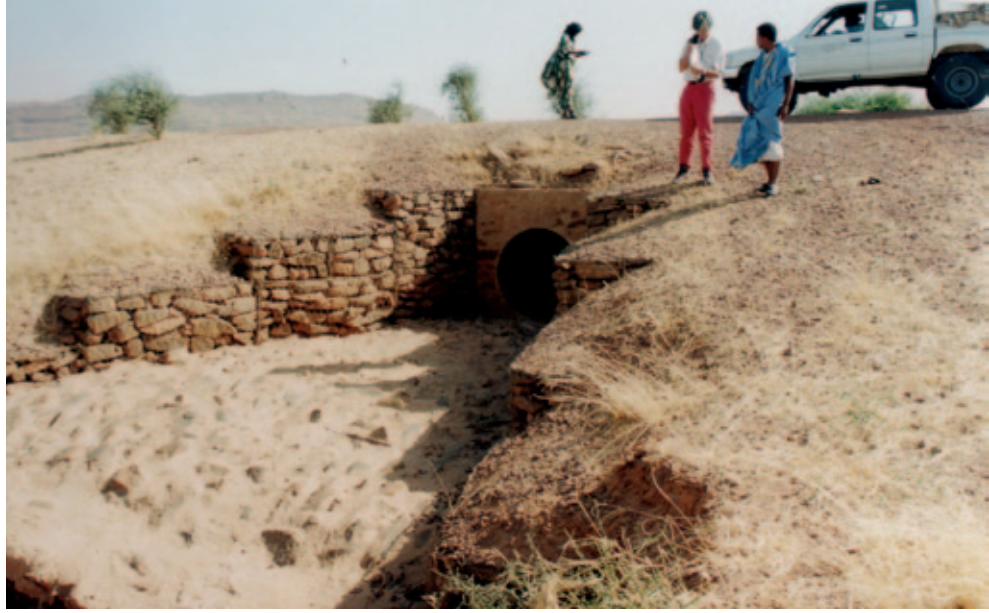
الصورة 17: صورة لسافلة السد لقناة تصريف سد اعونبات عر (تكانت). لاحظ الحماية الجيدة لحوض التبيد من الحجارة والدبشة، إلا أن الربط مع قاع الوادي غير جيد وقد أدى ذلك لظهور تآكل.
