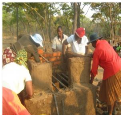
Construcción de un horno de arcilla. Foto por cortesía de Taurai Matope.
